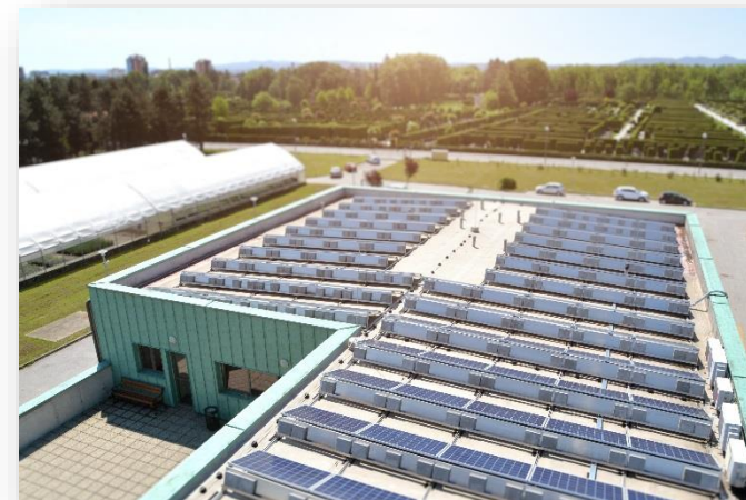
Fotonaponska elektrana 26 kW
